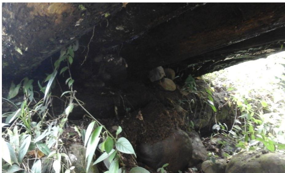
Fotografía 3.: Evidencia de la socavación en la base del puente, ocasionada por el evento hidrometeorológico.
