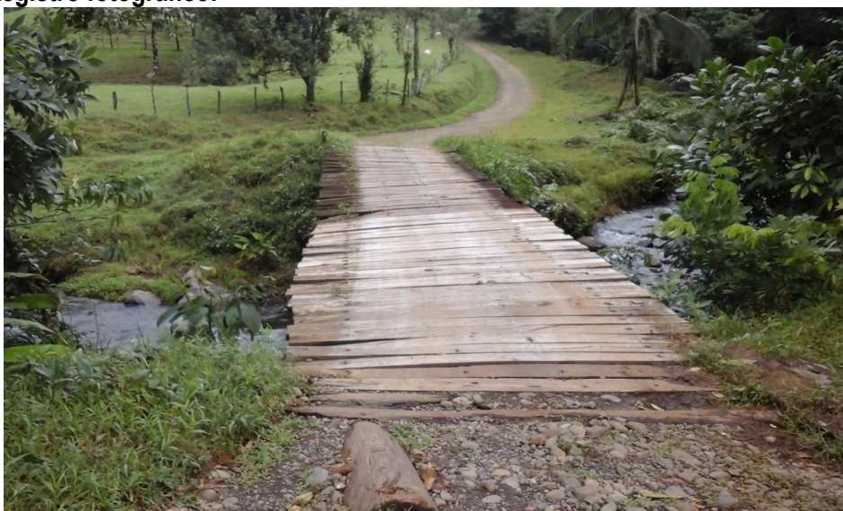
Fotografía 1.: Daños sobre la superficie del puente, ocasionados por el evento hidrometeorológico.
