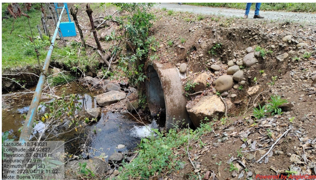
Fotografía 3. Evidencias de socavación en la estructura debido al exceso de caudal.
