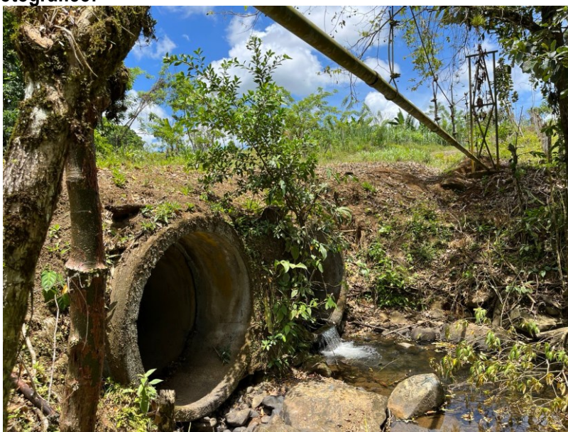
Fotografía 1.: Estado actual, posterior al evento hidrometeorológico.
