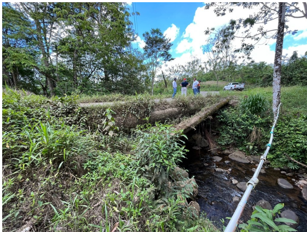
Fotografía 1.: Daño estructural en las vigas de madera y la superficie del puente, ocasionados por el evento hidrometeorológico.
