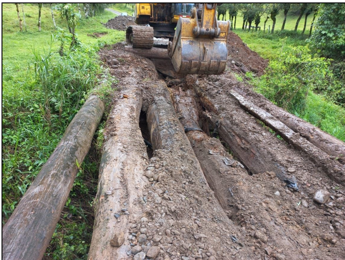
Imagen 7.: Fotografía tomada el día 25 de agosto de 2021, posterior al evento, en la que se evidencian los daños ocasionados a la estructura del puente artesanal. Se separaron las vigas, se segregó el material pétreo que tenía colocado como superficie y también se puede apreciar al menos una viga fracturada.
