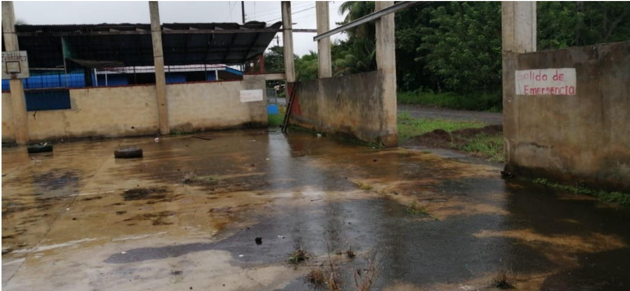
Figura 4. Estado interno de inmueble.
