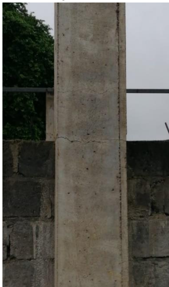
Figura 3. Falla estructural en una de las columnas.
