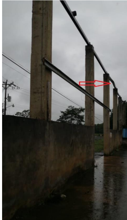
Figura 6. Viga cajón de amarre en acero fallada.
