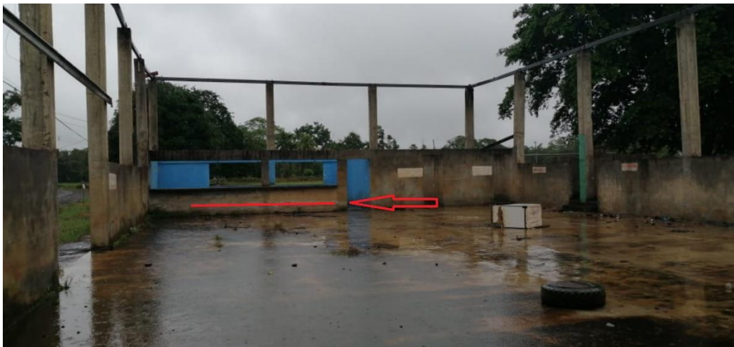
Figura 7. Línea testigo donde ha ascendido el agua en inundaciones anteriores.
